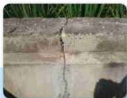
ひび割れ(縦方向)
