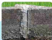
目地(つぎ目)の損傷
